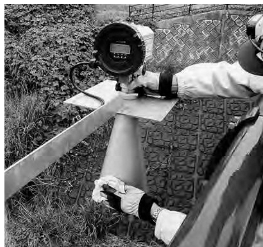
水位計（浅見川小松橋）
