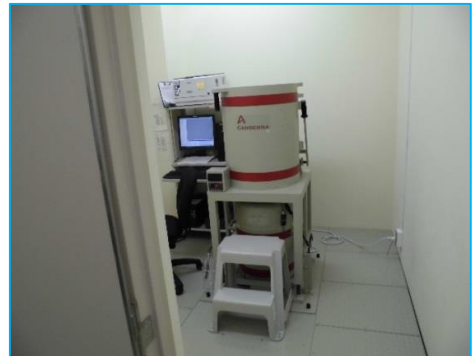
小山浄水場の機器類
