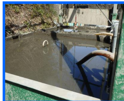
④凝集沈殿
