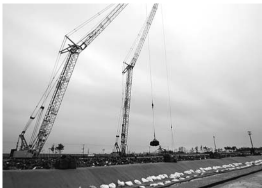
仮置き場で保管される汚染廃棄物
