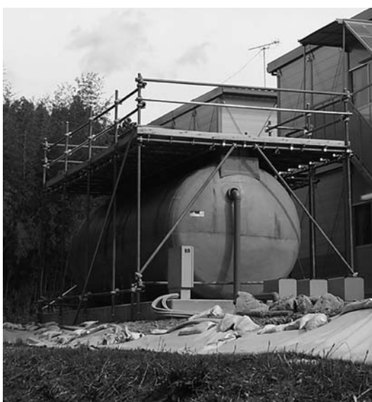
町内に設置されている合併浄化槽
