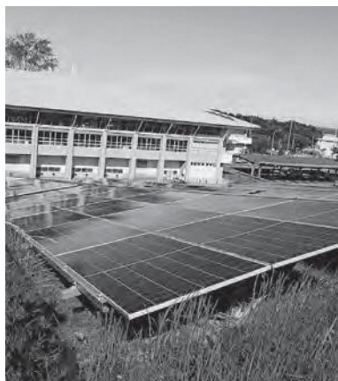
中央体育館協の太陽光発電設備
