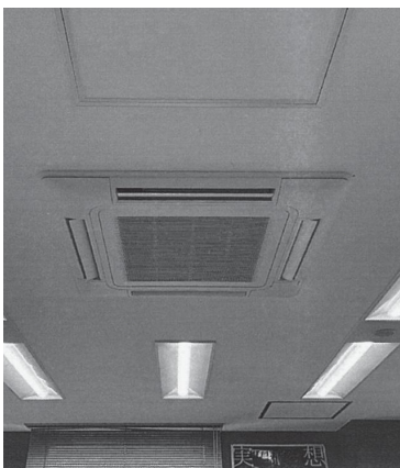
空調設備 施工後
