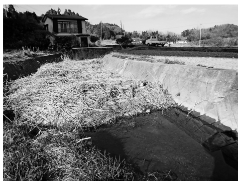
土砂が堆積している広野川
