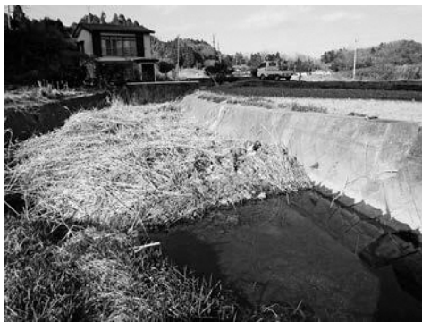
土砂が堆積している広野川
