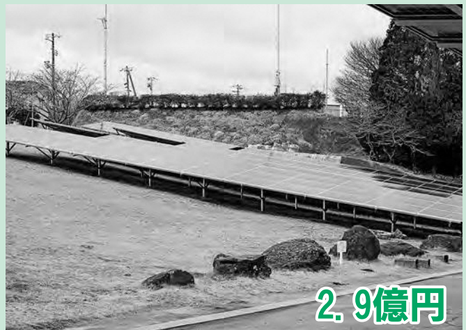
中央体育館南側法面に設置された太陽光パネル
