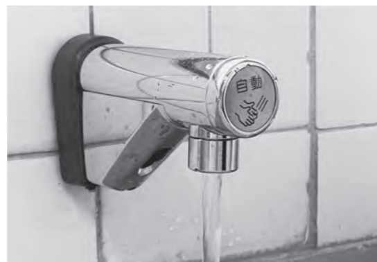
自動水栓となった蛇口（広野中学校廊下）
