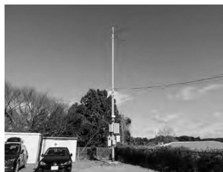
ラジオ受信障害対策基地局 (社会福祉協議会敷地内)
