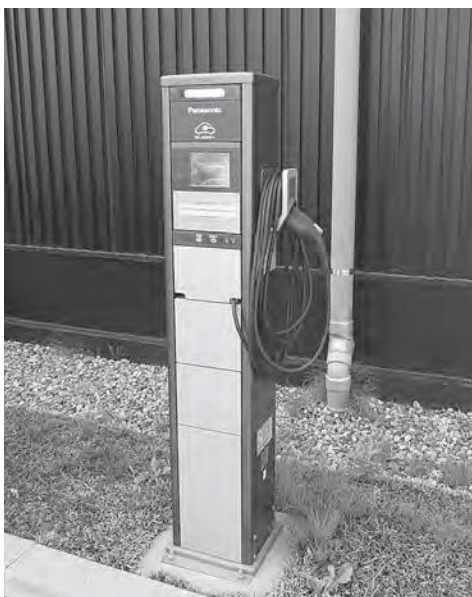
EV車充電設備
