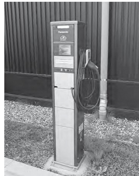
EV車充電設備
