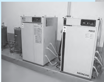
整備されたコンプレッサー設備
