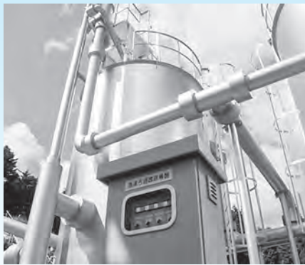
整備された現場盤とNo.1ろ過機
