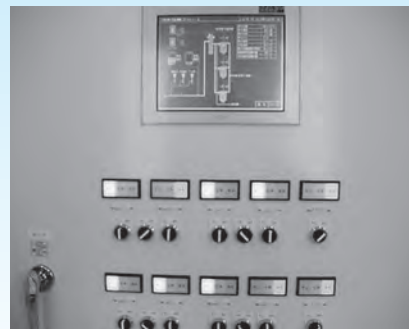
浄水場運転制御盤の一部
