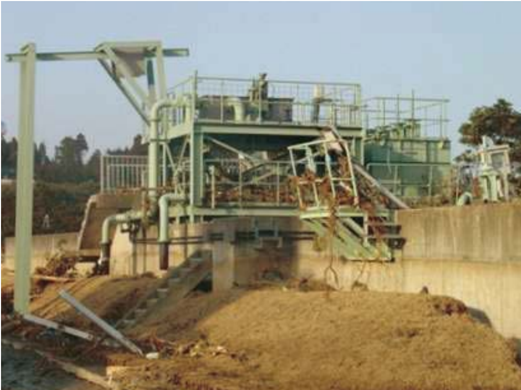
津波被害にあった 浄化センター
