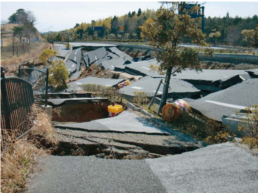
崩壊した国道6号線 二ツ沼地区 (平成23年3月11日)
