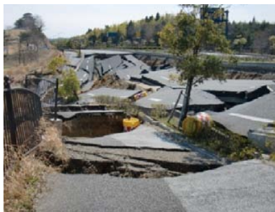
二ツ沼総合公園付近の国道 6 号線が崩落（3月11日）
