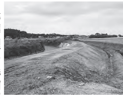
復旧が進む北迫川
