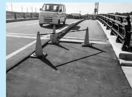
道路上に発生した段差
