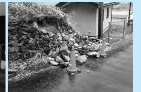
崩れた石積み
