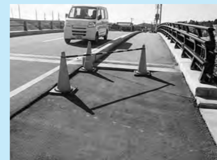
道路上に発生した段差
