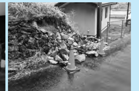
崩れた石積み
