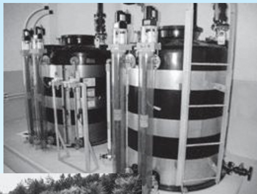
塩素注入用のポンプとタンク
