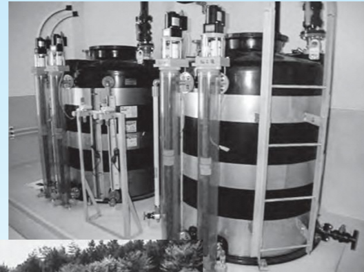
塩素注入用のポンプとタンク
