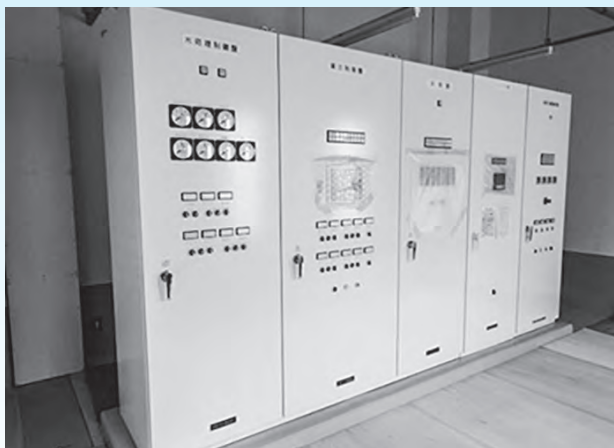
設置された制御盤
