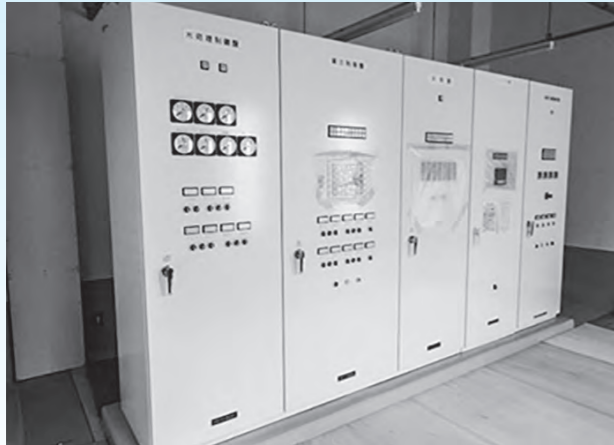
設置された制御盤
