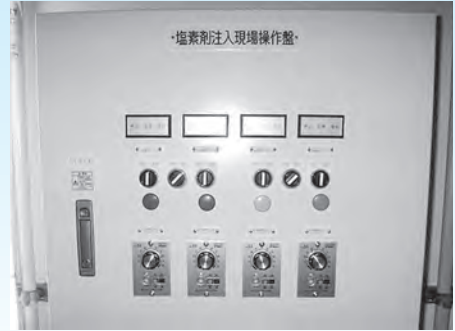
薬品注入設備制御盤
