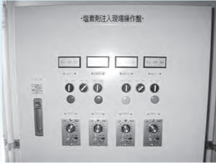
薬品注入設備制御盤
