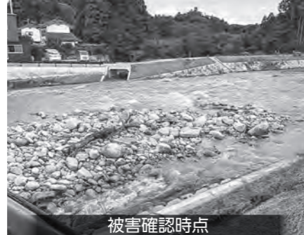
被害確認時点
