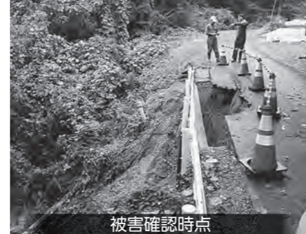
被害確認時点
