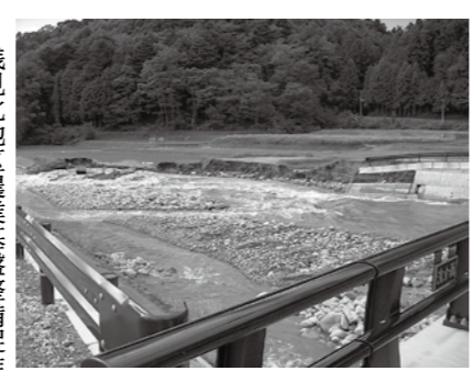
台風19号による浅見川護岸の被害の様子
