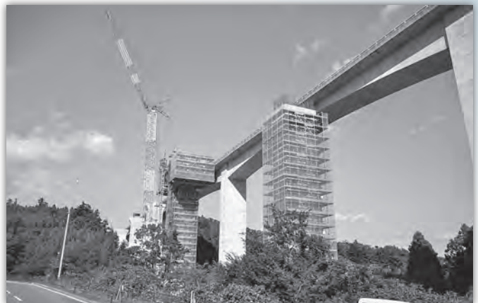
常磐自動車道4車線化（いわき中央インターから広野インター間）事業（上北迫地内の工事の様子）9月25日撮影
