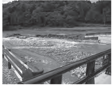
台風19号による浅見川護岸の被害の様子
