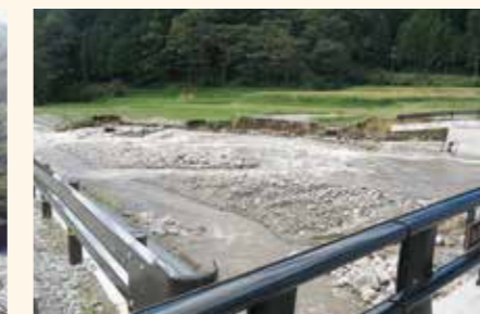
浅見川護岸の被害（上浅見川字寺所地内 浅倉橋付近）
