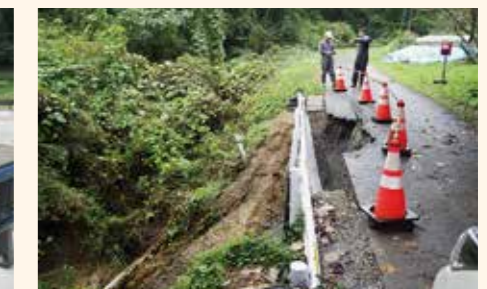
町道鍋塚・土ヶ目木線路肩崩落（上北迫字鍋塚地内）
