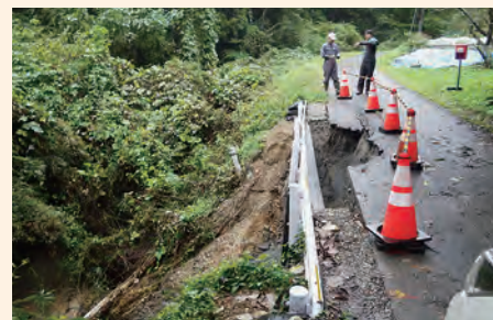
町道鍋塚・土ヶ目木線路肩崩落 (上北迫字鍋塚地内)
