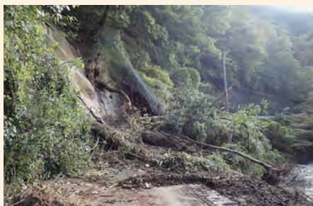
県道上戸渡・広野線の路肩崩落 (上浅見川字鈴平地内)
