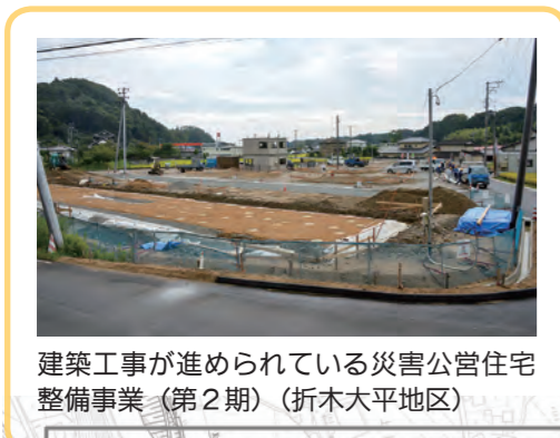
建築工事が進められている災害公営住宅整備事業（第2期）（折木大平地区）
