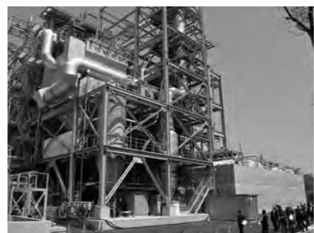
災害廃棄物等仮設減容化処理施設
