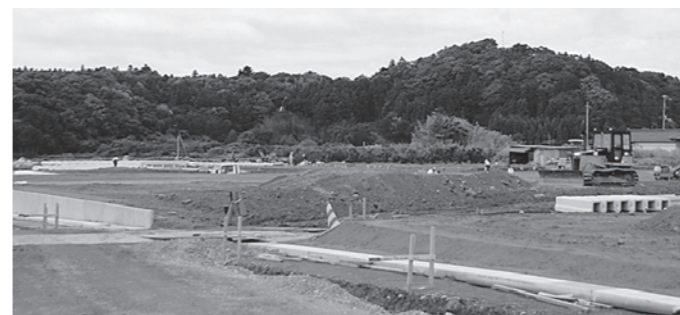
↑ 災害公営住宅建設予定地
