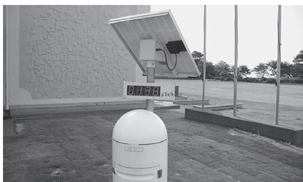
広野小学校に設置されているモニタリングポスト
