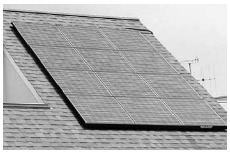
新エネルギーの太陽光発電用パネル
