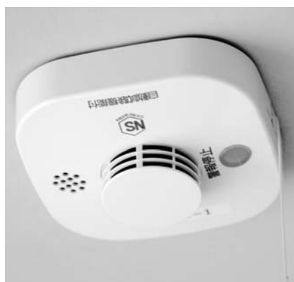
平成23年5月31日までに設置することが義務づけられている住宅用火災報知器
