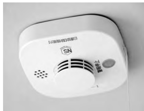
▲平成23年5月31日までに設置することが義務づけられている住宅用火災報知器
