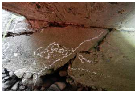
40. 桜田第二橋：RC床版橋 (橋長：3.30m、1965年竣功) 橋台前面のひびわれ・断面欠損 ※地震等の外力により、損傷は進行する可能性が高い。(迂回路有り)
