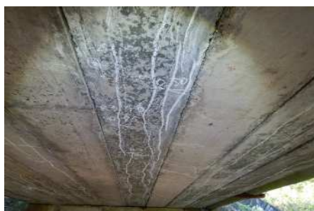
11. 牛道橋：プレテン床版橋 (橋長：28.07m、1964年竣功) プレテン桁下面の橋軸方向ひびわれ ※雨水の浸入により、進行する可能性が高い。(迂回路有り)
