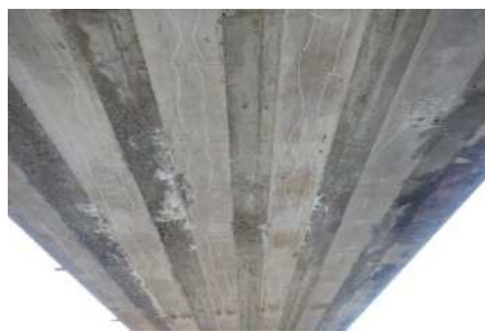
20. 長畑橋：プレテン床版桁 (橋長：27.00m、1975年竣功) プレテン桁下面の橋軸方向ひびわれ ※雨水の浸入により、進行する可能性が高い。(迂回路有り)
