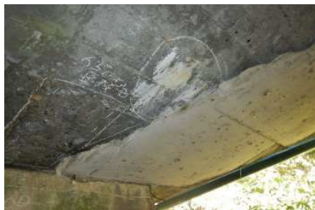
35. 第三南沢橋：RC床版橋 (橋長：4.50m、1975年竣功) 床版下面の錆汁を伴う遊離石灰の析出 ※雨水の浸入により、内部鋼材の腐食が進行する可能性が高い。(迂回路有り)
