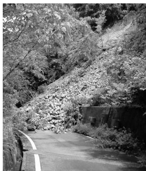
大雨災害による土砂崩れ現場 (夕筋地区)
