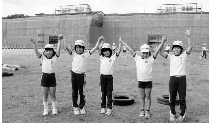
およそ1億円の予算をかけて大規模改修工事が行われている小学校
