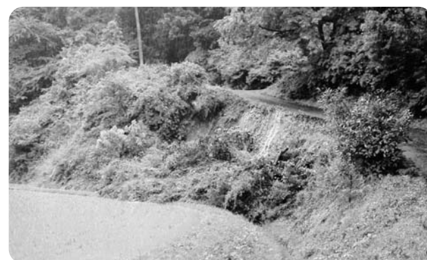
土砂崩れで農業用水が閉塞（関ノ上地区）
