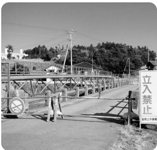
早急な復旧が待たれる北迫川河口部
