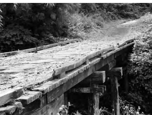
国有林林道に架かる木橋(上浅見川字下帯平)
