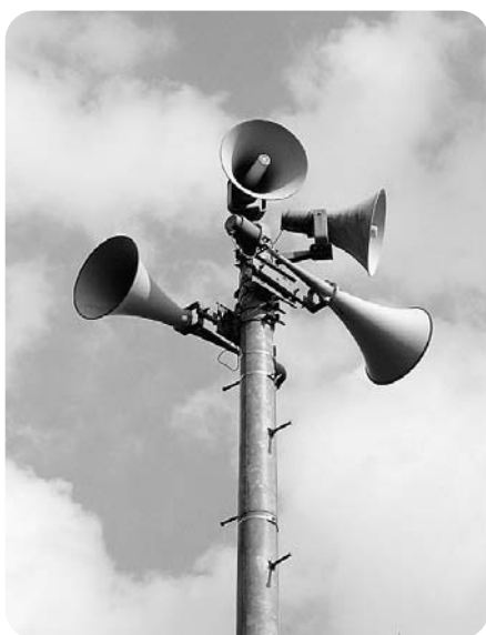
防災行政無線の屋外スピーカー
