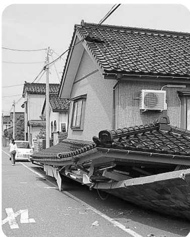
地震被害にあった木造住宅 (写真提供：首都大学東京 土質研究室)
