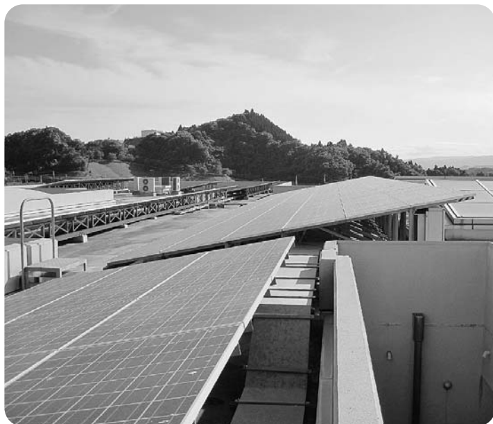
近隣市町村の校舎屋上に設置されている太陽光発電パネル
