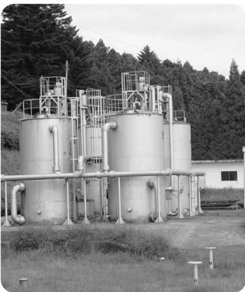
町内各家庭に配水している小滝平浄水場
