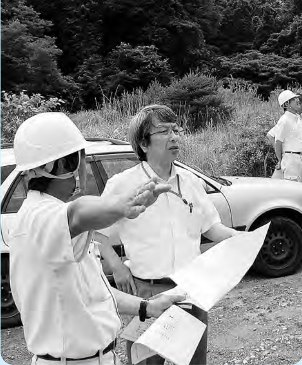
20年度工事の実施状況を確認する小貫春夫代表監査委員
