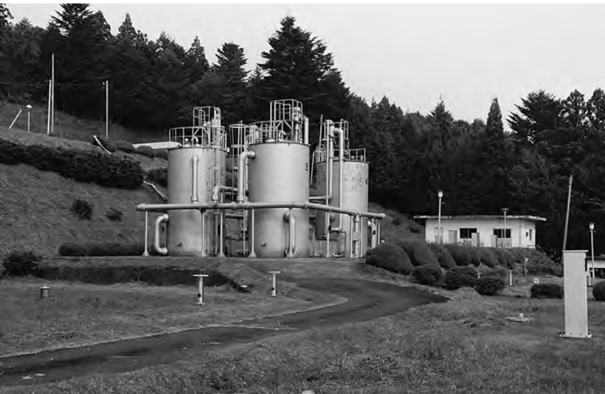
▲現在は小滝平浄水場から町内に配水されている
