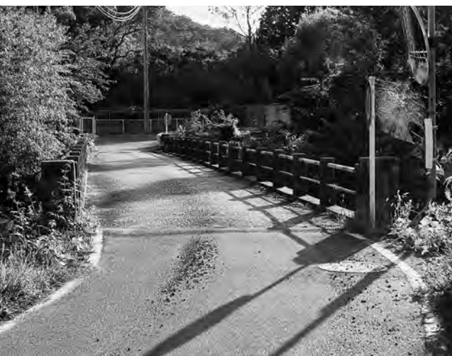
▲H23年度中の着手を見送られた小松橋整備事業
