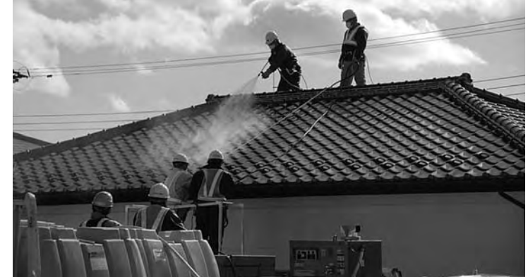
▲一般住宅の除染作業が始まった中央台地区（国の実証モデル事業）
