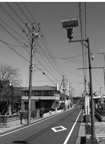
占用が許可されている電柱
