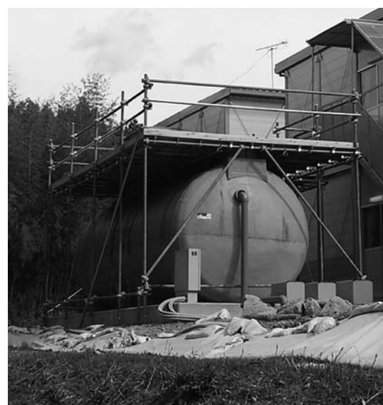
町内に設置されている合併浄化槽
